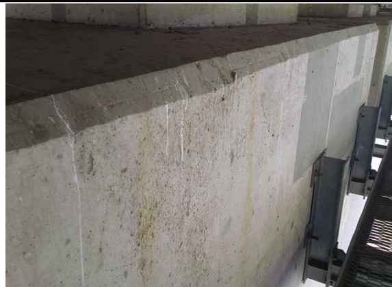
P6 코핑부 균열(폭 0.2mm)
