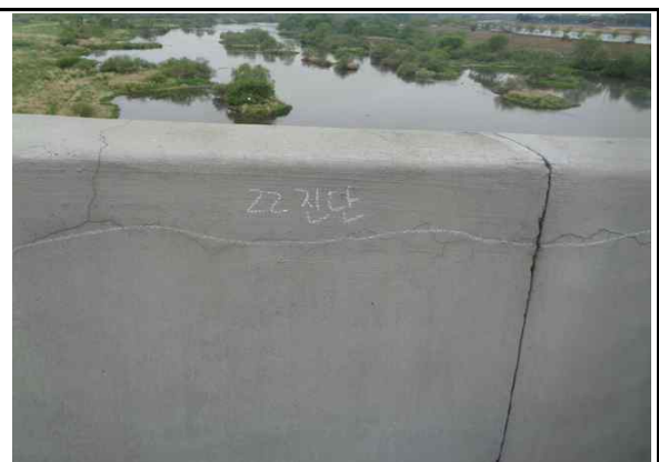
S6 방호벽 균열(폭 0.2mm)
