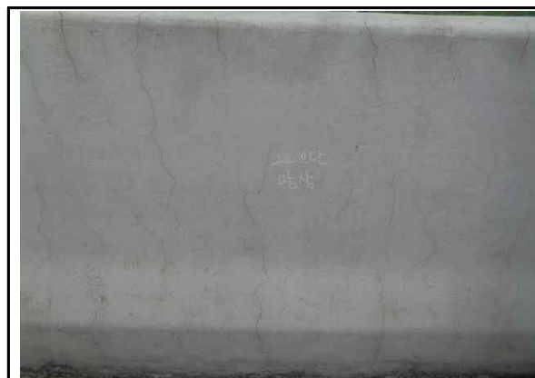
S6 방호벽 망상균열
