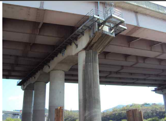
P7 코핑부 및 기둥부 누수오염
