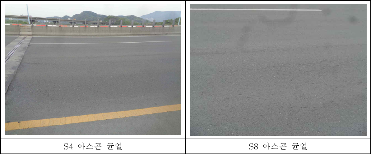
<표 3.22> 범물방향 교면포장 외관조사 결과
