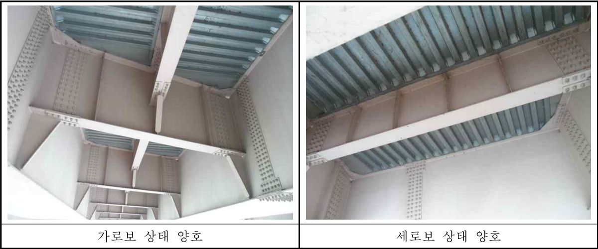
<표 3.6> 범물방향 가로보 외관조사 결과
