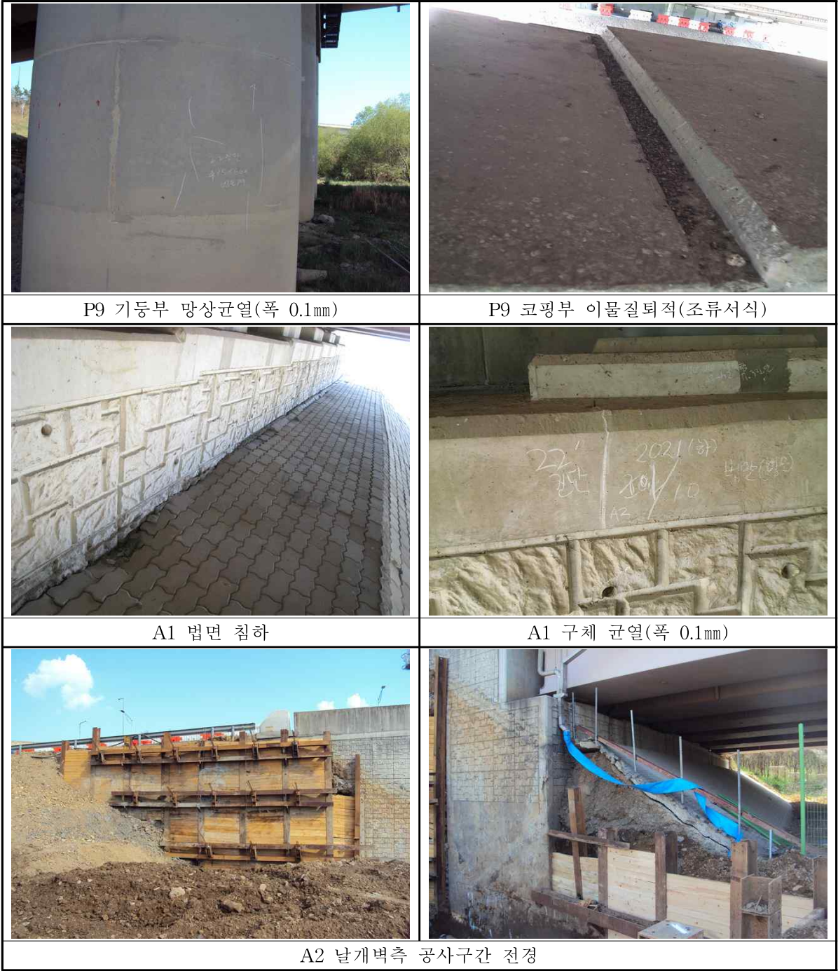
<표 3.10> 범물방향 하부구조 외관조사 결과
