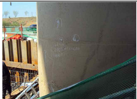
P8 기둥부 콘크리트 균함
